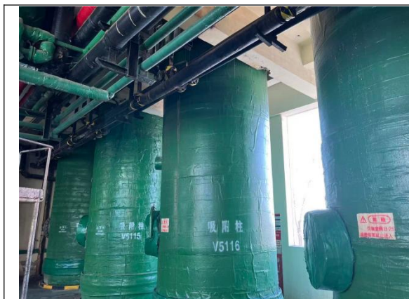
废水预处理设施
