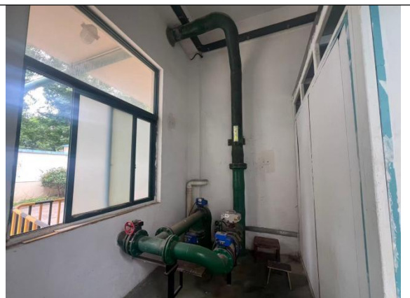
污水排口 DW001
